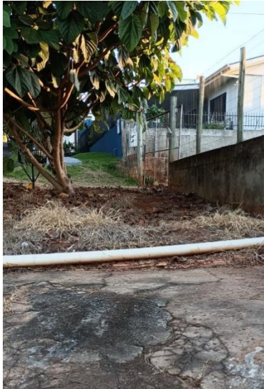
Figura 1- Calçadas sem manutenção - Rua José Tatto, Bairro Fraron - Pato Branco -PR
