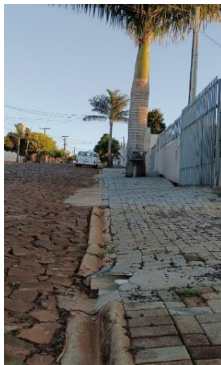
Figura 8 - Calçada com obstáculo - Rua Veríssimo Rizzi, Bairro Fraron - Pato Branco - PR
